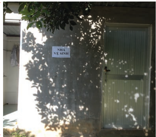
Hình 11. Nhà vệ sinh tự hoại
